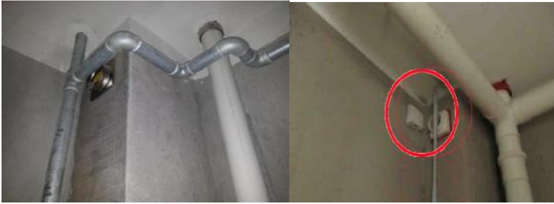
图 2 管线遮挡进气口
