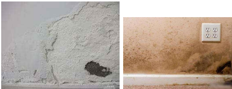
图2 卫生间外侧墙体受潮、发霉
